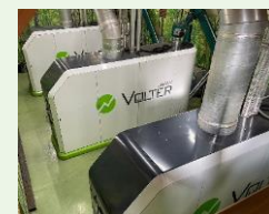
小型木質バイオマス熱電併給設備
